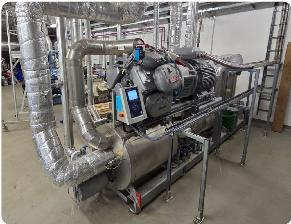
Wärmepumpe bei der Block Menü
