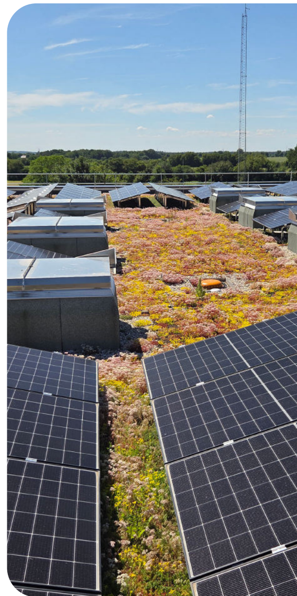
PV-Anlagen auf dem Gründach der Block Menü
